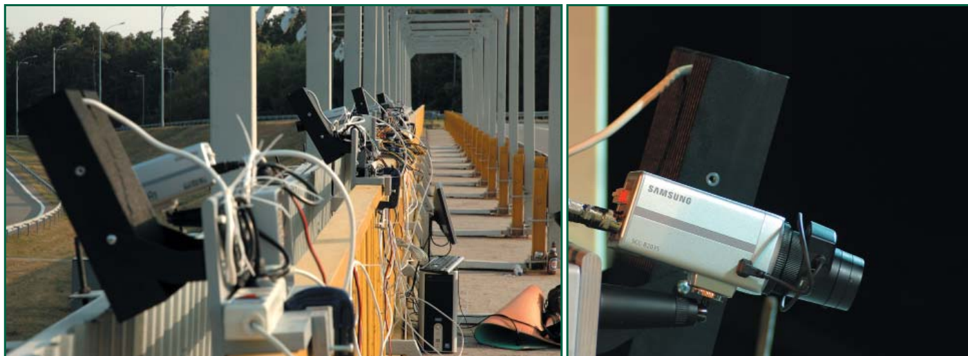
Аналоговые телекамеры с ИК-прожекторами, установленные на эстакаде.
